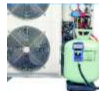
Sistemas de refrigeração e A/C comercial
